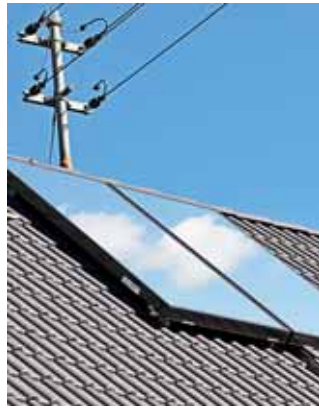
Die neue Solaranlage auf dem Dach des Hauses von Familie Georgiadis: Fünf Quadratmeter reichen aus, um den Warmwasserbedarf des Gebäudes zu decken. Foto: djd/IWO - Institut für Wärme und Oeltechnik
